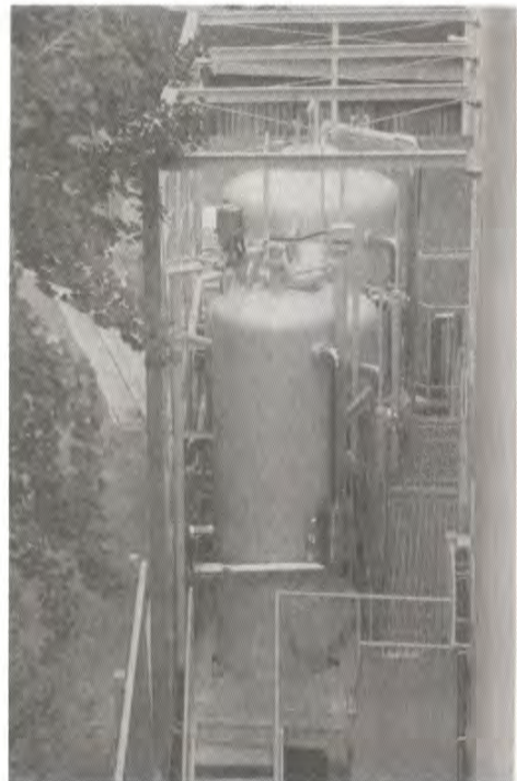
二号館裏に設置されている有害重金属を対象にした三次処理装置の全体図
